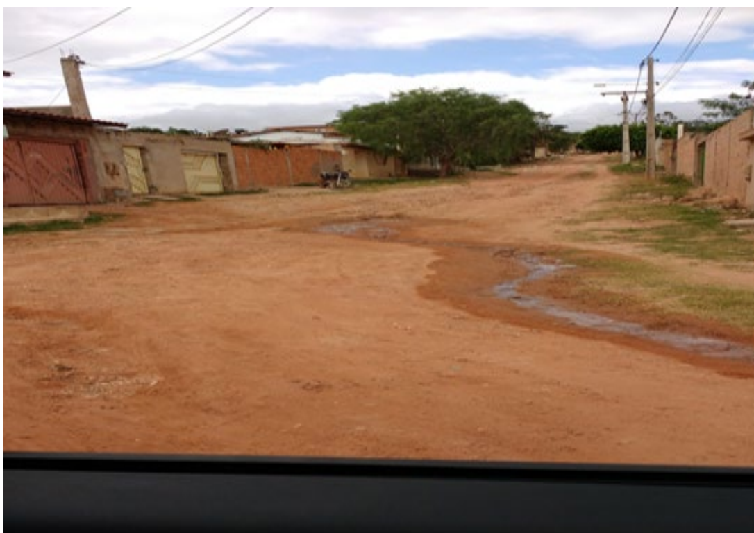
Figura 4 - Esgoto a céu aberto
