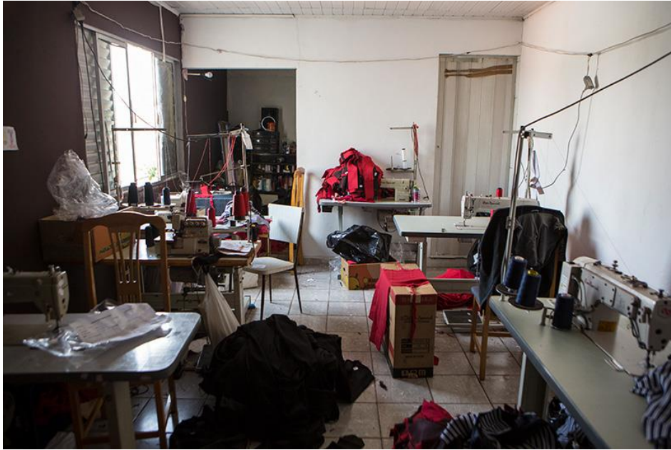
FIGURA 6: Instalações elétricas em oficina de costura da marca Animale
