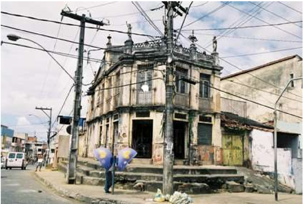
Imagem 06. Fachada vista da esquina do Casarão nº 622. Fonte: IPAC.
